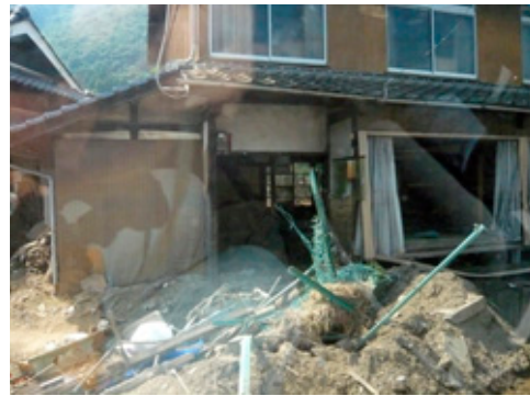
被災して土砂が散乱する家屋
