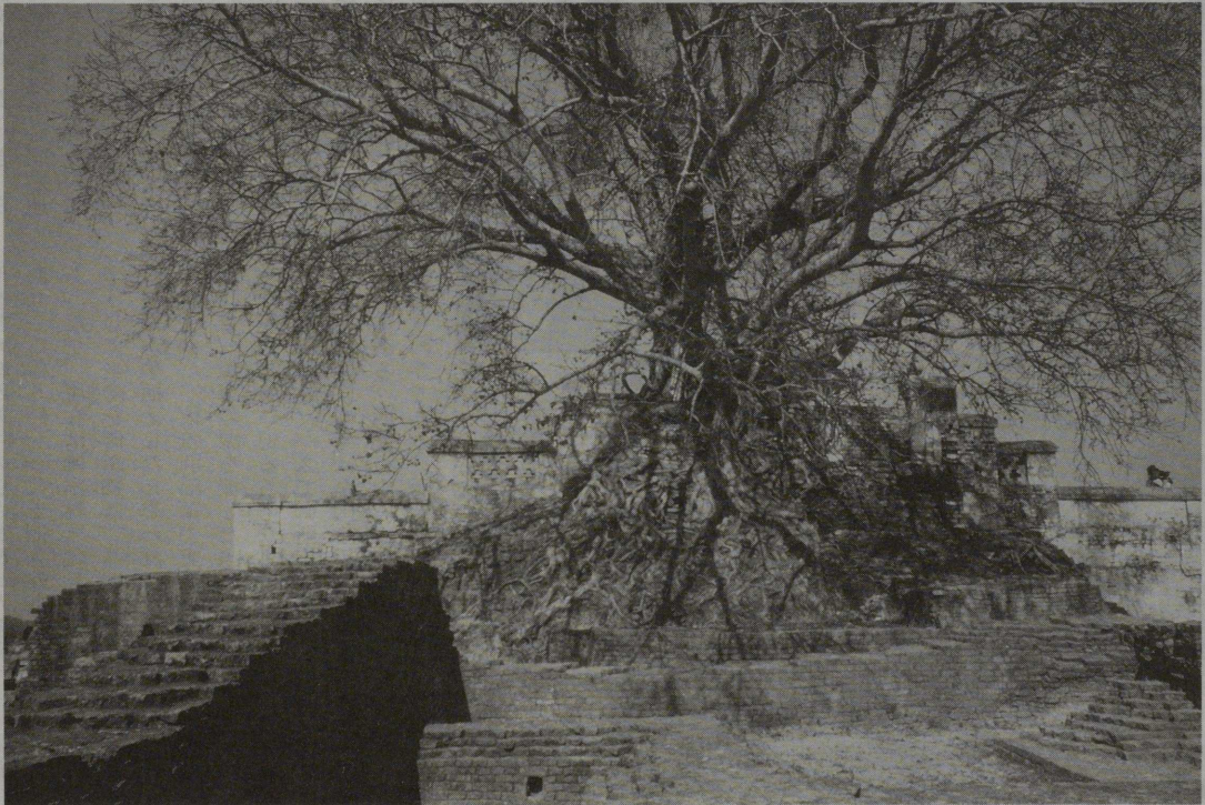
マヤ堂を崩壊に追い込む菩提樹の根
