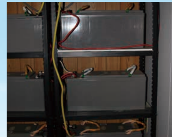
オフグリッドハウスの蓄電器
