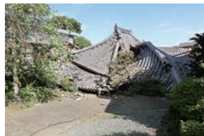
熊本地震により全壊した寺院
