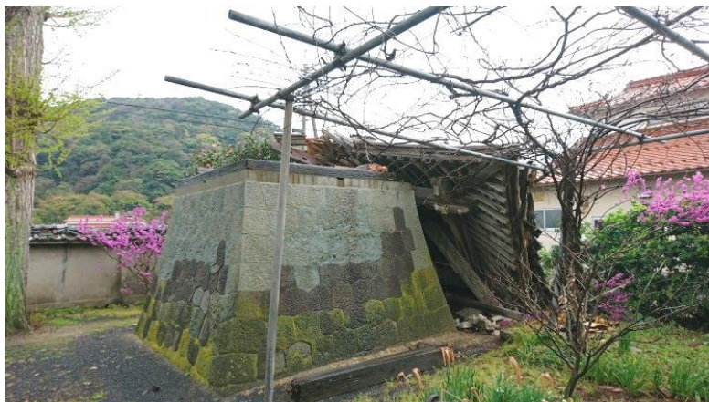
浄土真宗本願寺派寺院…鐘樓の倒壊等被害
