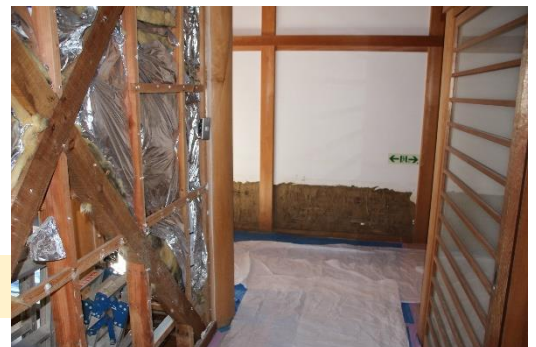
令和元年台風第 19 号被害寺院の様子：善導寺(長野県) →
