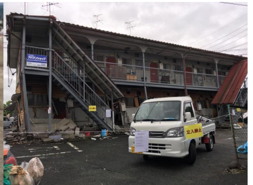
倒壊した建物
